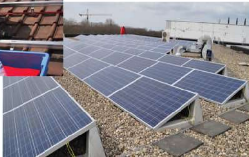
سیستم فتوولتائیک روی سقف مسطح
